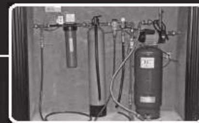
TRATAMIENTO DE AGUA
